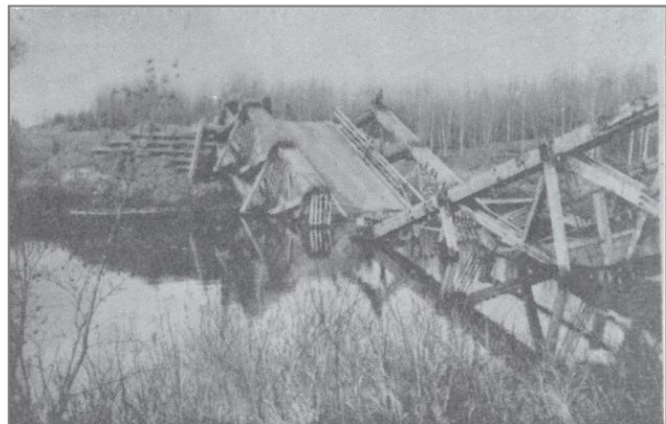
Printemps 1938, effondrement du pont rang 6, lots 50-51
